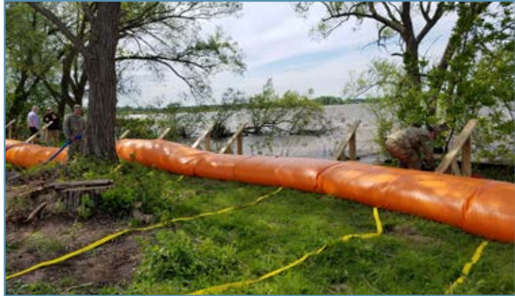
Des agents de la New York National Guard plaçant un système de protection tubulaire dans la baie Braddock du lac Ontario pour protéger le rivage contre les crues, le 1 er juin. Photo: New York National Guard
